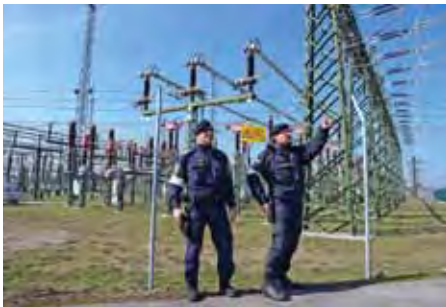
Übungsbeobachter an der Außenseite des Umspannwerkes.
